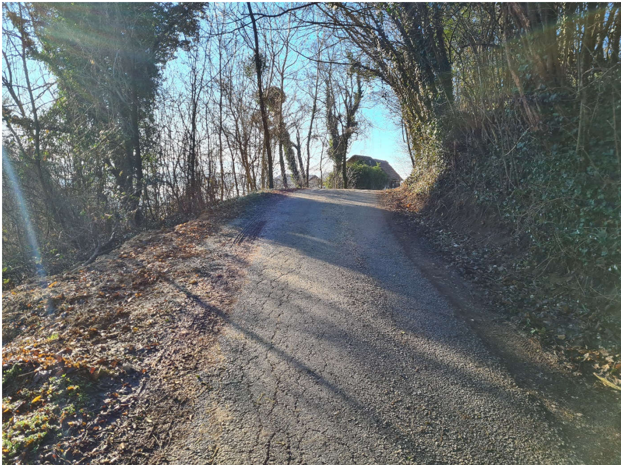
Slika 9 Početak nestabilnosti – uzdužne mrežaste pukotine
