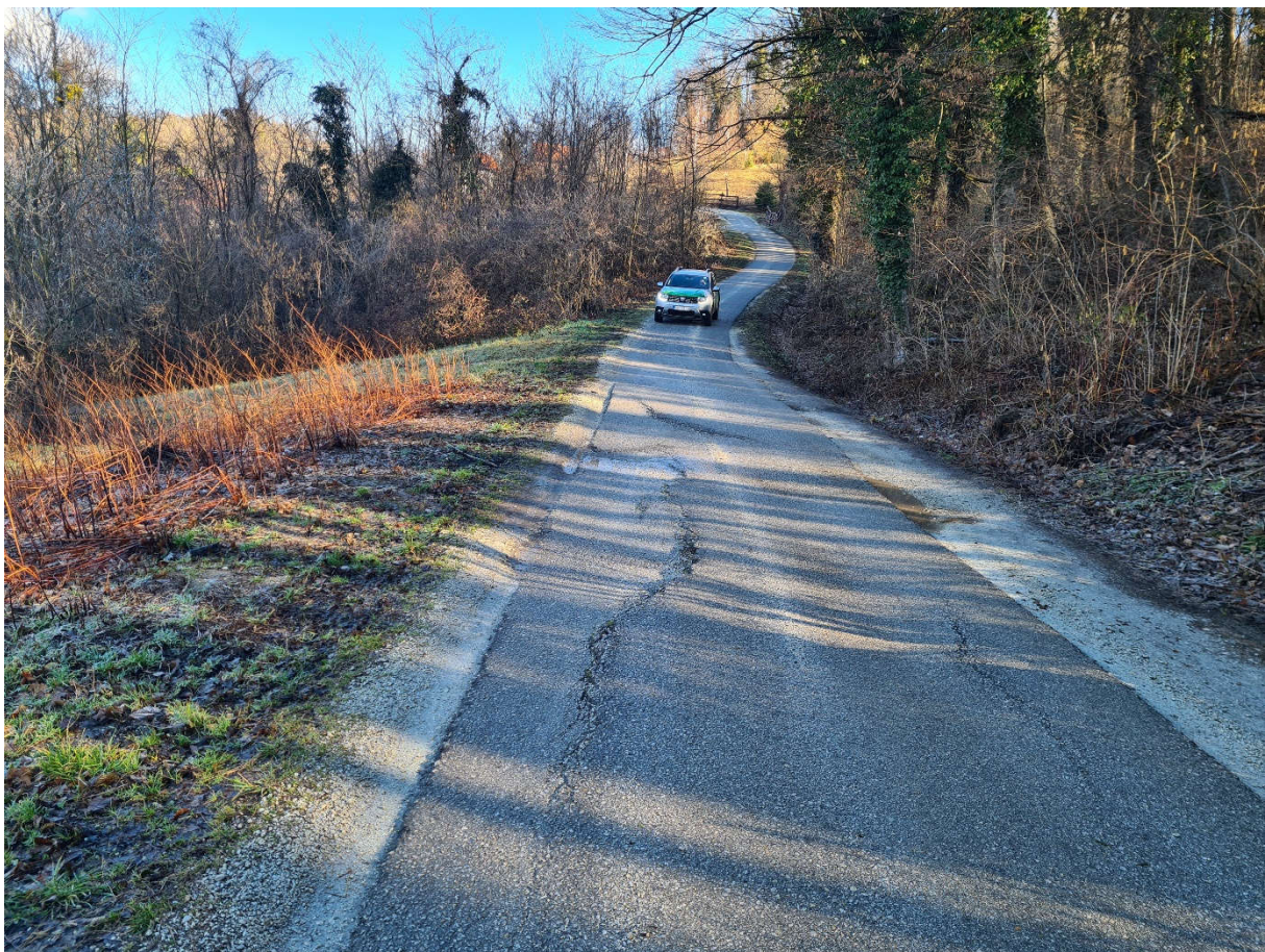
Slika 9 Prikaz nabora asfalta na lokaciji
