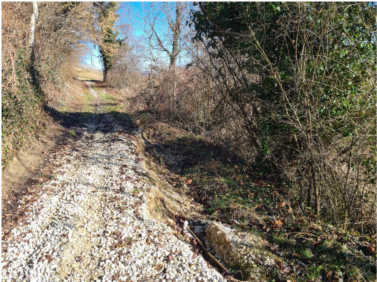
Slika 9 Prikaz odronjenog dijela ceste
